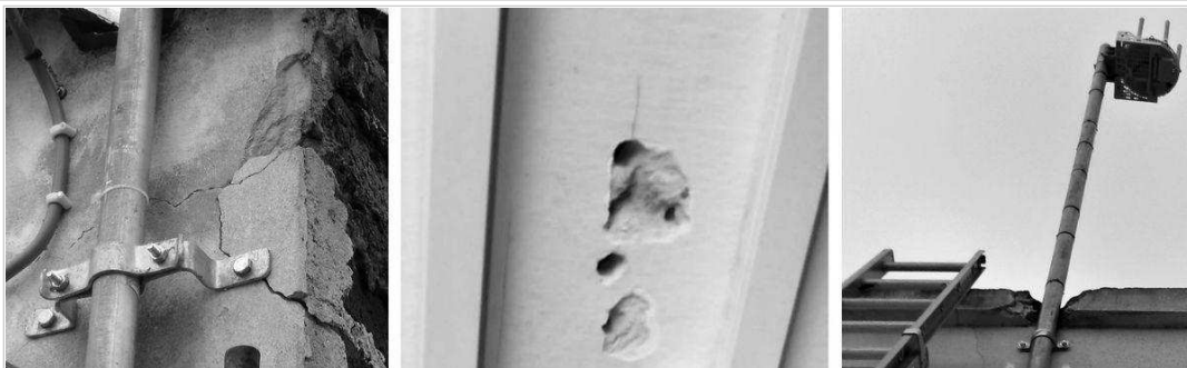
Fig. 1 - Ejemplos de afectación a infraestructura de terceros
