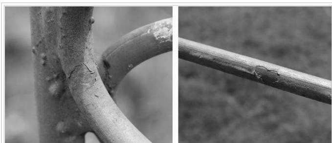
Fig. 1 - Desprendimiento del galvanizado
