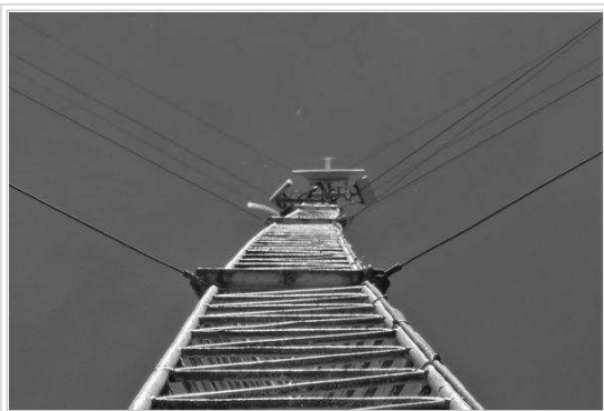
Fig. 6 - Falta de verticalidad
