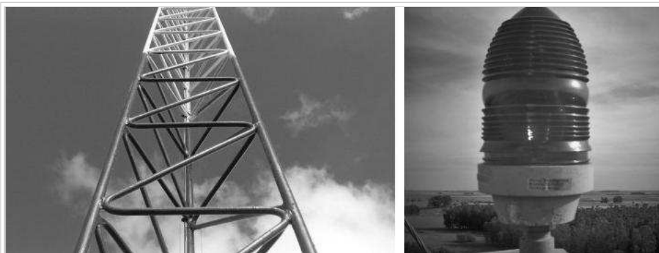
Fig. 9 - Balizamiento diurno (izq), Balizamiento nocturno (der)
