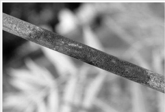
Fig. 13 - Corrosión superficial en rienda por contacto Cobre-Galvanizado
