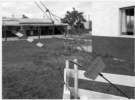
Fig. 5 - Señalización de riendas
