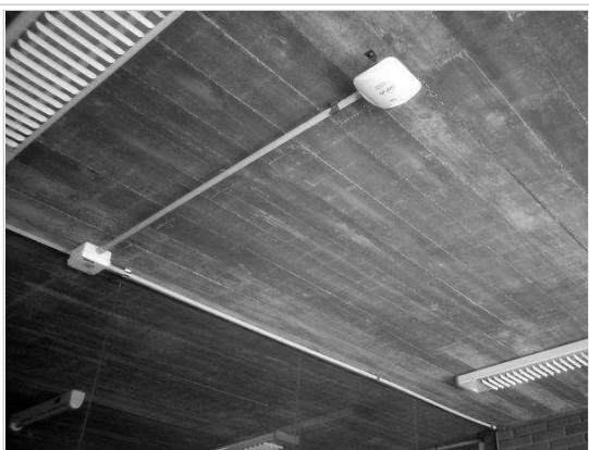
Fig. 1 - AP Aruba fijado a cielorraso común
