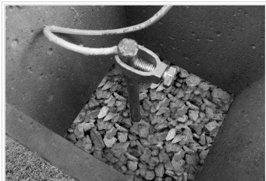
Fig. 2 : Cámara de puesta a tierra
