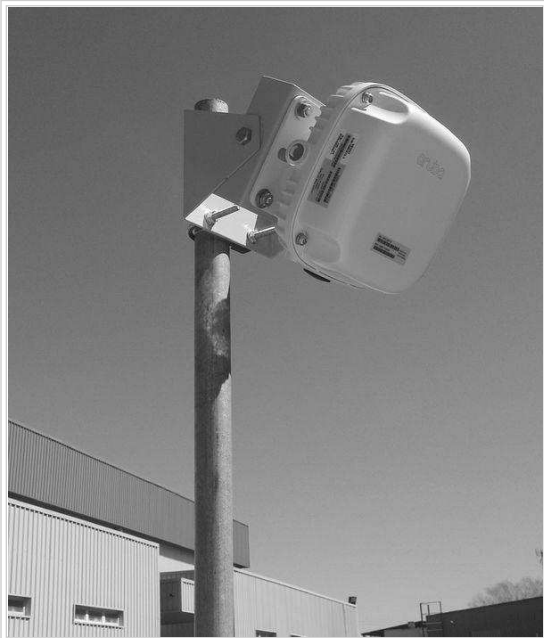
Fig. 1 - Equipo Aruba AP-367-RW fijado a caño
