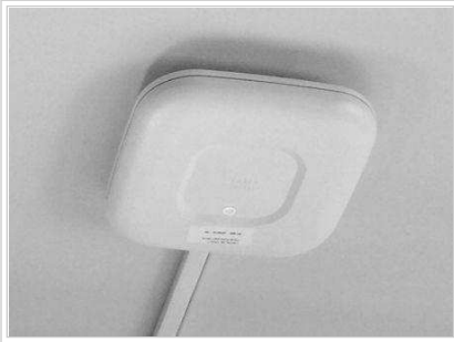
Fig. 2 - AP Cisco fijado a cielorraso común
