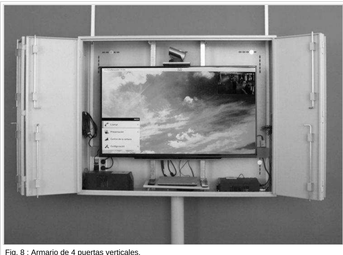
Fig. 8 : Armario de 4 puertas verticales.
