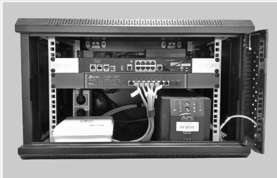
Fig. 4 : Disposición de equipos en rack 6U
