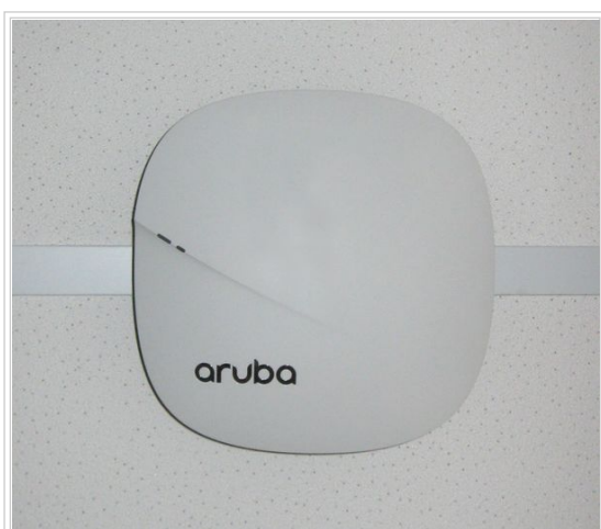
Fig. 3 - AP Aruba fijado a cielorraso tipo Armstrong
