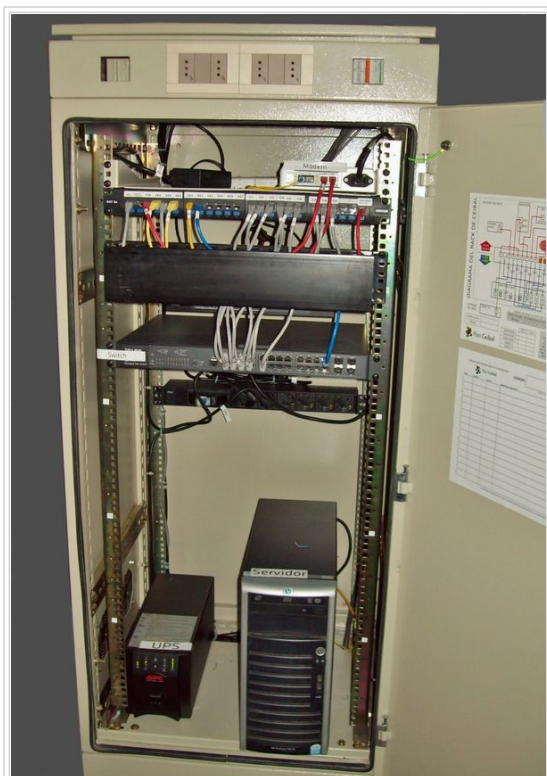
Fig. 3 : Interior de rack
