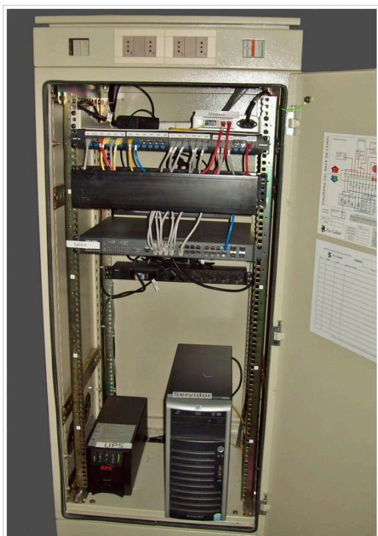
Fig. 3 : Interior de rack
