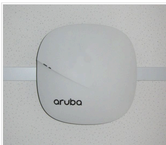
Fig. 3 - AP Aruba fijado a cielorraso tipo Armstrong
