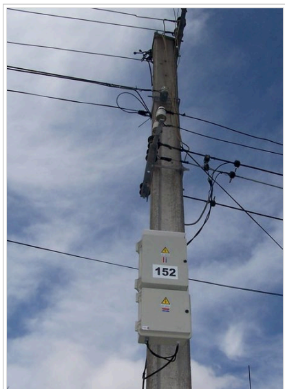
Fig. 1 Gabinete con AP y antena integrada.
