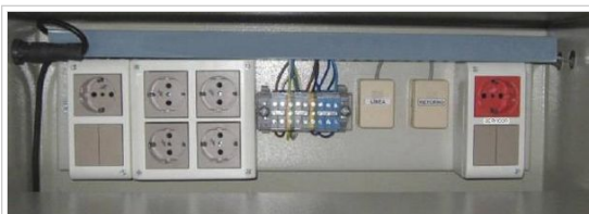
Fig. 4 : Bandeja eléctrica con bornera
