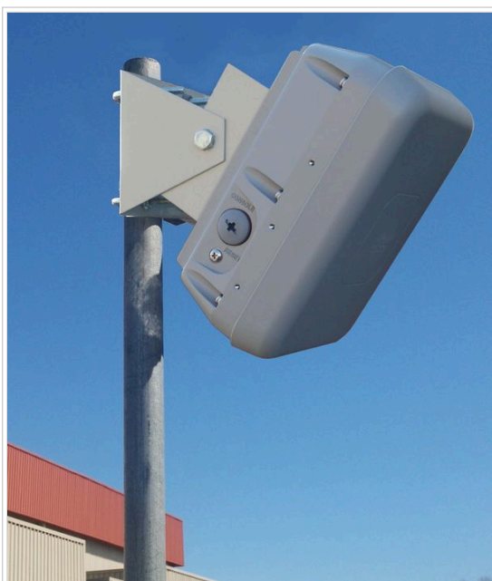
Fig. 1 - Equipo Cisco 1562-D fijado a caño
