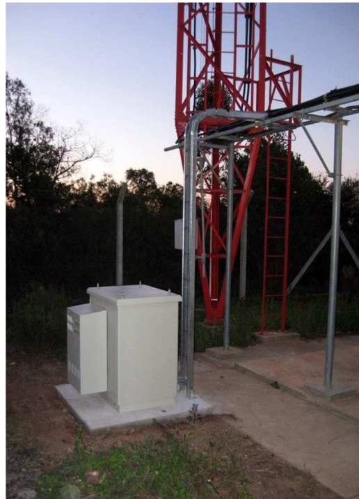
Fig. 10 – Shelter para equipos
