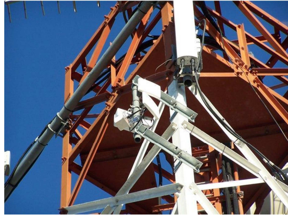
Fig. 8 – Equipo y antenas en torre
