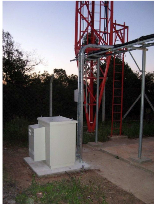
Fig. 10 – Shelter para equipos
