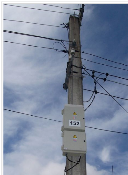
Fig. 1 Gabinete con AP y antena integrada.
