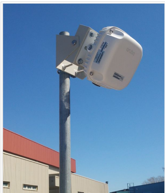
Fig. 1 - Equipo Aruba AP-367-RW fijado a caño
