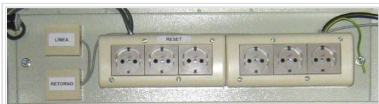
Fig. 6 : Bandeja eléctrica sin bornera
