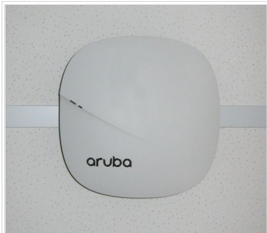
Fig. 3 - AP Aruba fijado a cielorraso tipo Armstrong
