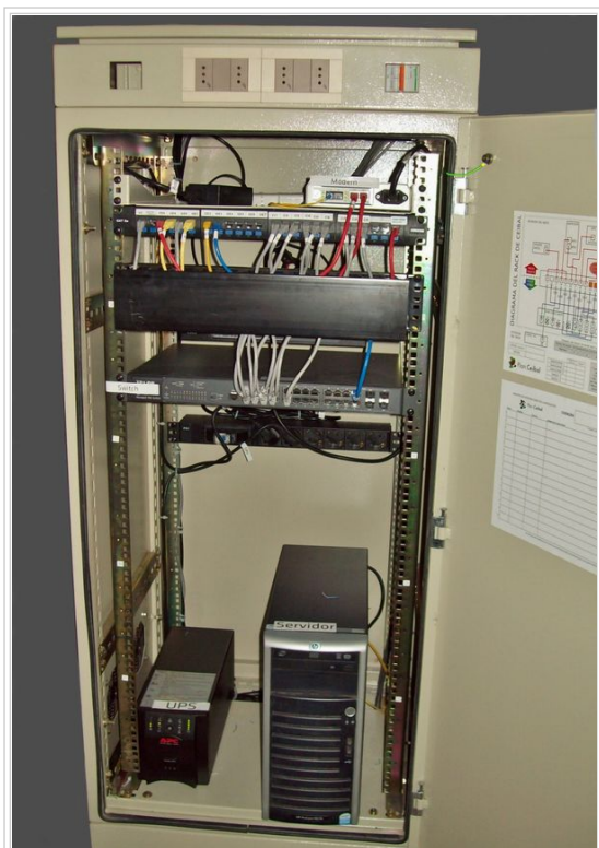
Fig. 3 : Interior de rack
