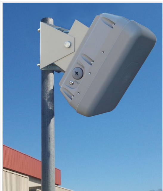
Fig. 1 - Equipo Cisco 1562-D fijado a caño
