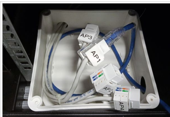
Fig. 5 : Interior de caja con jacks
