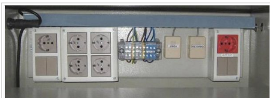
Fig. 4 : Bandeja eléctrica con bornera
